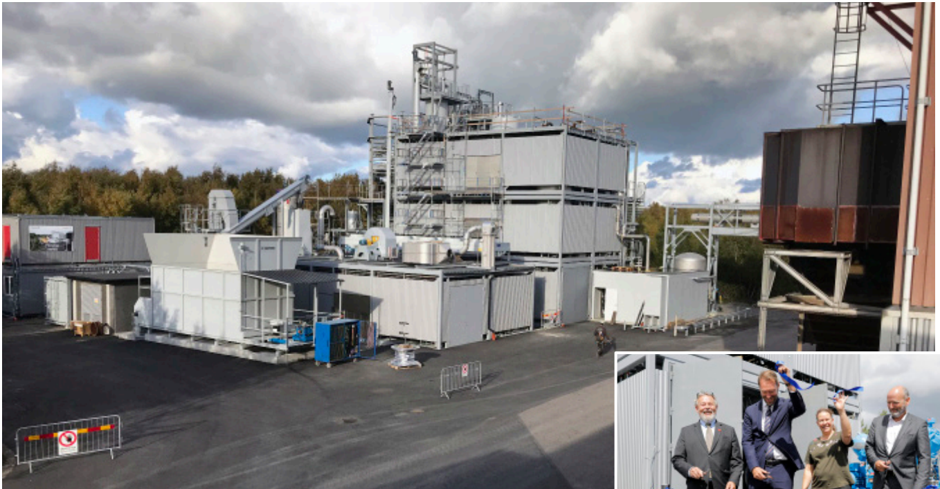
Installationen i Höganäs per 1 oktober 2018.
