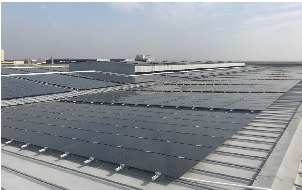
En av ASRE:s anläggningar i Kina, om 1,43 MW. Installerad på Shaoxing Longze Pipeline Co's fastighet.
