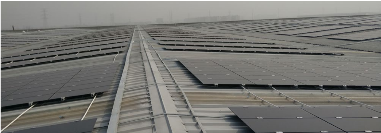
En av ASRE:s anläggningar i Kina, om 4 MW. Installerad på Zhejiang Jindun Fire Control Equipment Co. Ltd.
