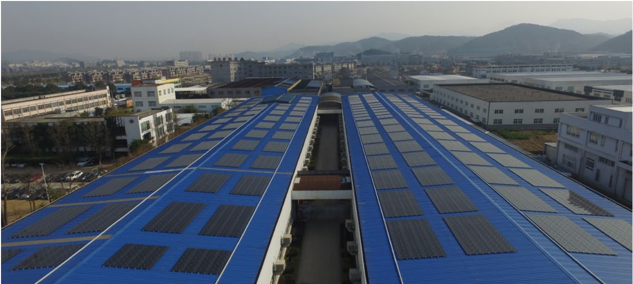
En av ASRE:s anläggningar i Kina om 450 kW installerat på Ningbo Sente Auto Parts Co. Ltd.
