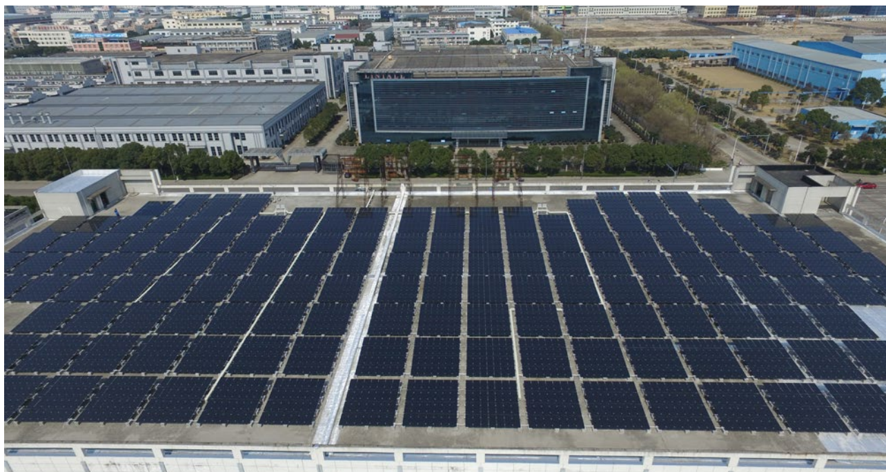
En av ASRE:s anläggningar i Kina, om 1,74 MW. Installerad på Fenghua Xuri Hangyu Co.Ltd.
